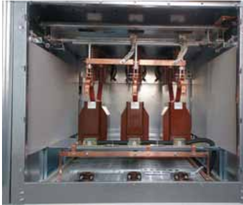
Kablo Bağlantı Bölümü
